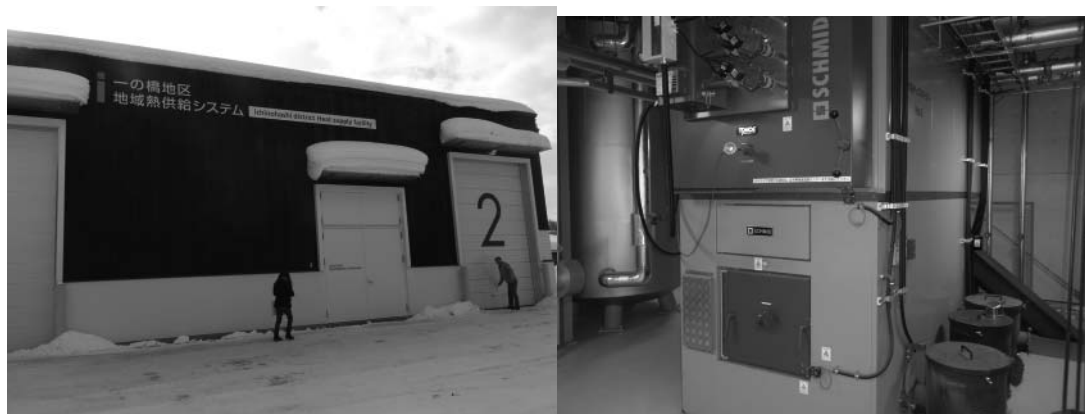
写真 2 一の橋集落におけるバイオマスボイラー
