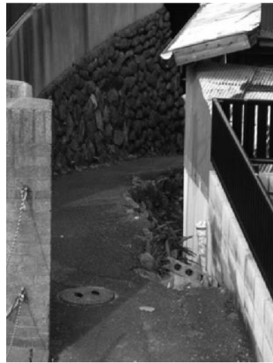
写真2 手すりの未設置例
